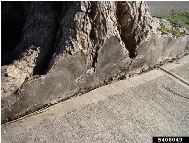
Figura 19. La construcción es especialmente dañina para las raíces, como estas raíces cortadas durante la reparación de aceras y bordillos.
